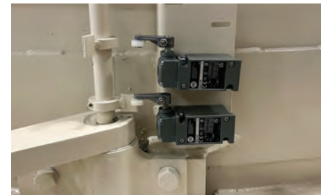
Discharge door position limit switches
