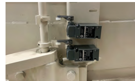
Discharge door position limit switches
